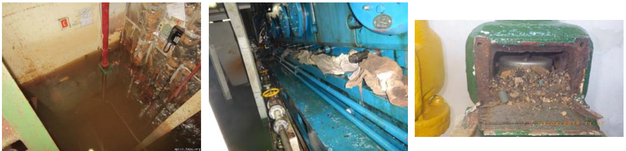
2019年域内PSC検査における欠陥事例
